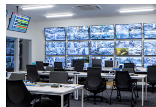
同工場のコントローラー室
